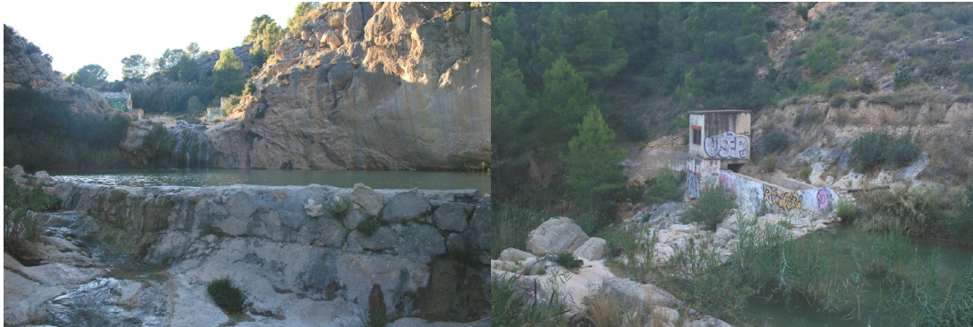
Figura 1. Presas y tomas de agua en Rambla de Perea (Región de Murcia)
