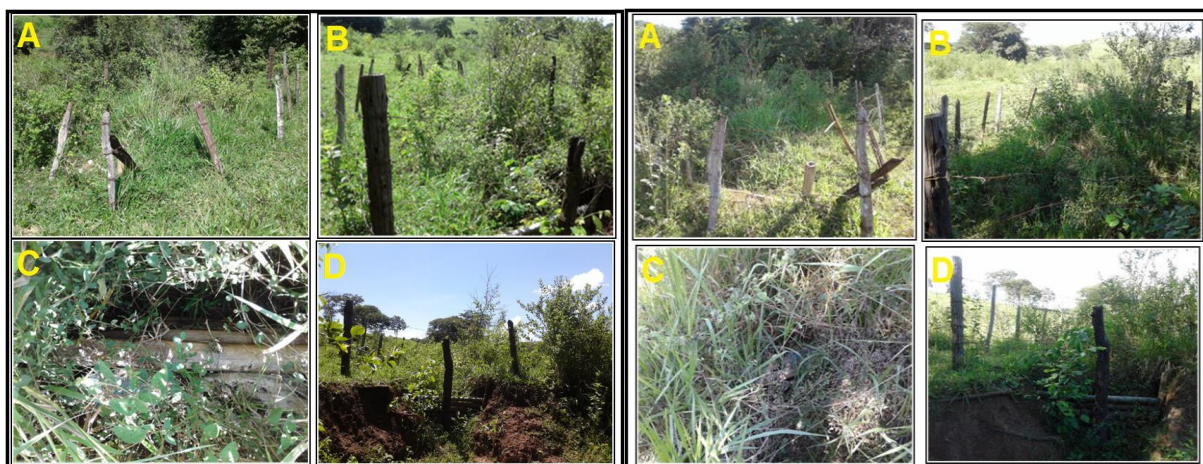
Figura 297 (Esquerda) Acompanhamento da recuperação da ravina no dia 22/03/2018 | Fonte: fonte própria.
