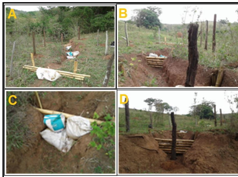
Figura 294 Acompanhamento da recuperação da ravina no dia 28/10/2017 | Fonte: fonte própria.
